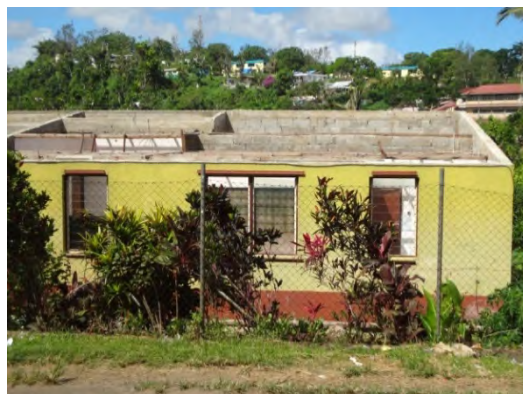
写真4 屋根が吹き飛んだ家
