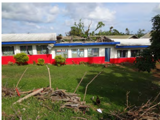
写真3 破損した学校
